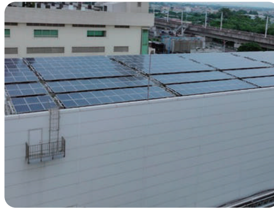
▲ 屋頂型太陽能持續建構，總規劃三期，第一期及第二期已完工。
